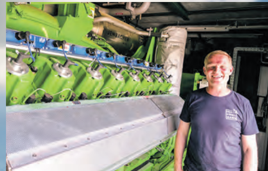
Drei Motoren wandeln das gewonnene Biogas in Strom um. Der 2024 installierte 16-zyllindrige Motor erbringt 1.248 Kilowatt und ist damit das leistungsstärkste Aggregat der Anlage.
