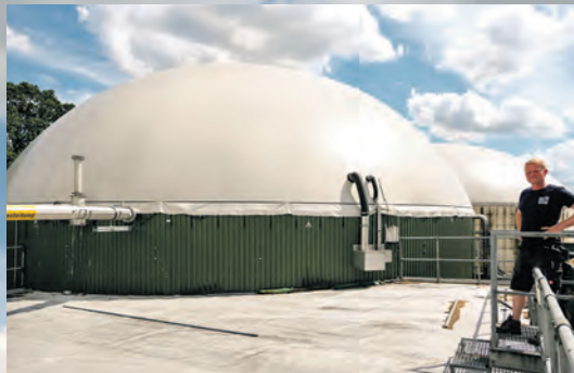
Auf dem Dach des beheizten Hauptgärers, auch Fermenter genannt, wo Bakterien die eingebrachten Inputstoffe unter Ausschluss von Sauerstoff zersetzen. Im Hintergrund ist das Endlager zu sehen.
