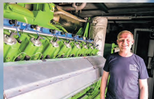
Drei Motoren wandeln das gewonnene Biogas in Strom um. Der 2024 installierte 16-zyklindrige Motor erbringt 1.248 Kilowatt und ist damit das leistungsstärkste Aggregat der Anlage.
